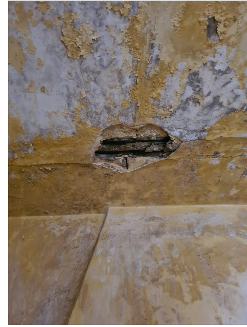
Foto 8: Dettaglio di una porzione di solaio ammalorata
