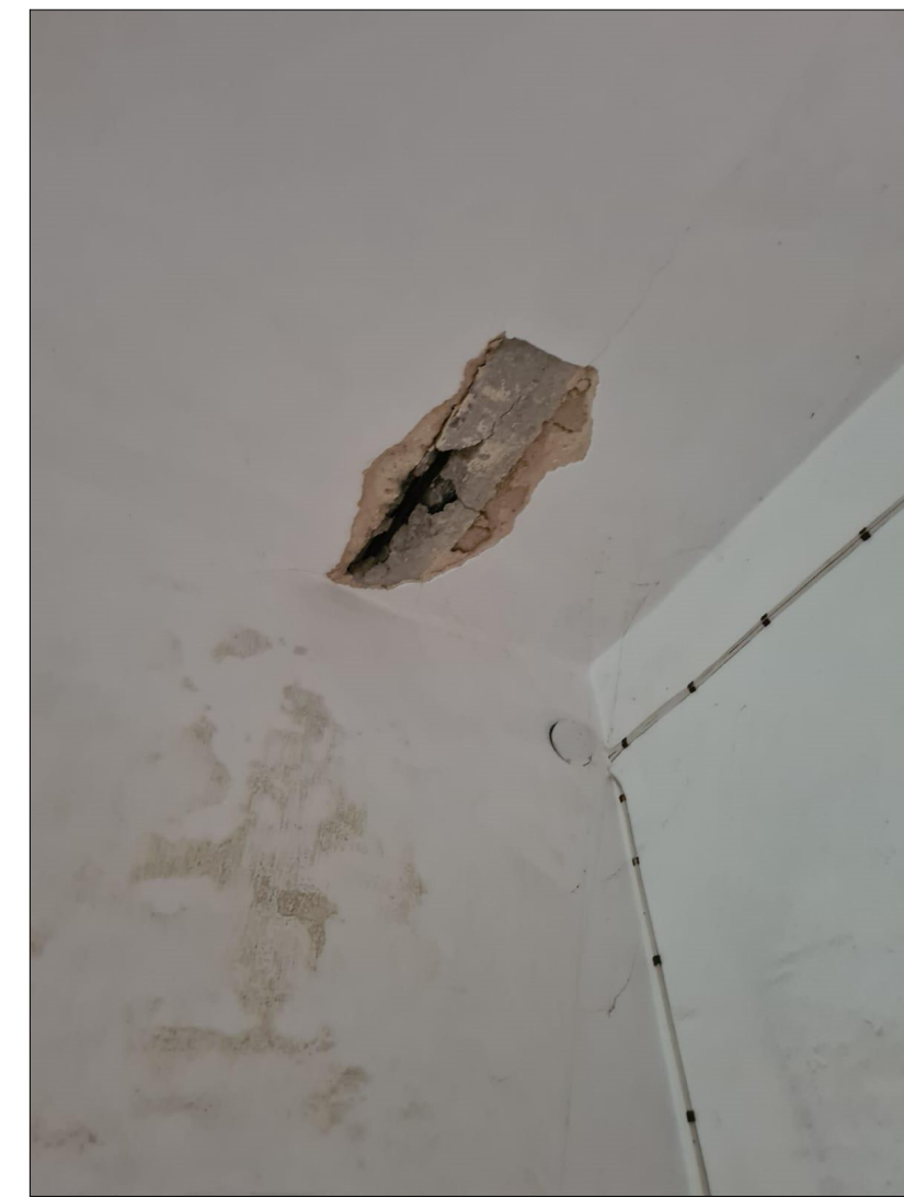
Foto 7: Dettaglio di una porzione di solaio ammalorata
